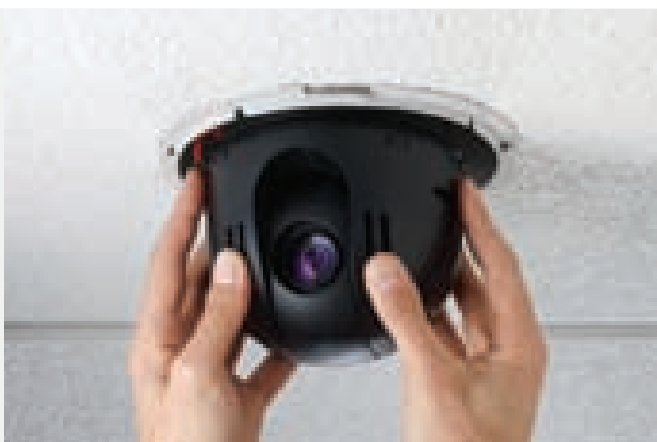
Vložit nový kamerový modul PTZ „vyměnitelný za provozu“...
